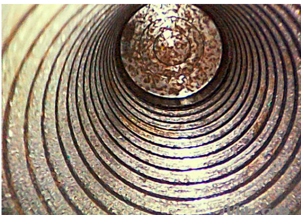
Compresor de aire
